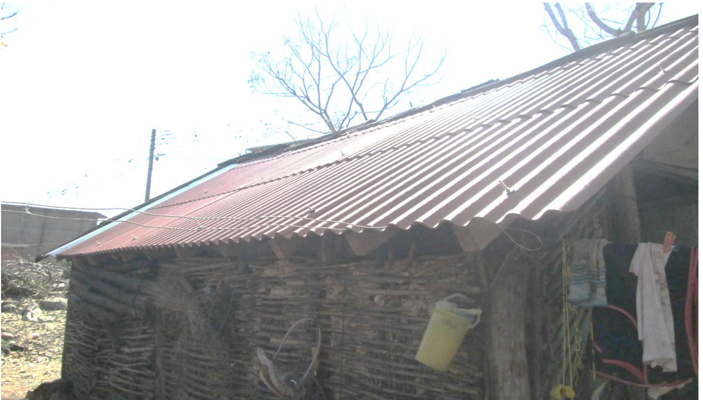
55 Foto de vivienda de bajareque con lámina de ferrocemento.
