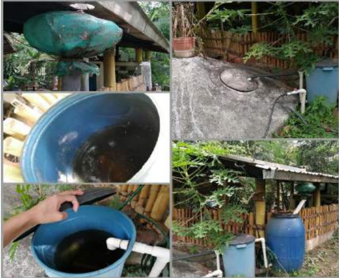
Ilustración 13. Sistema de Captación de Agua de Lluvia
