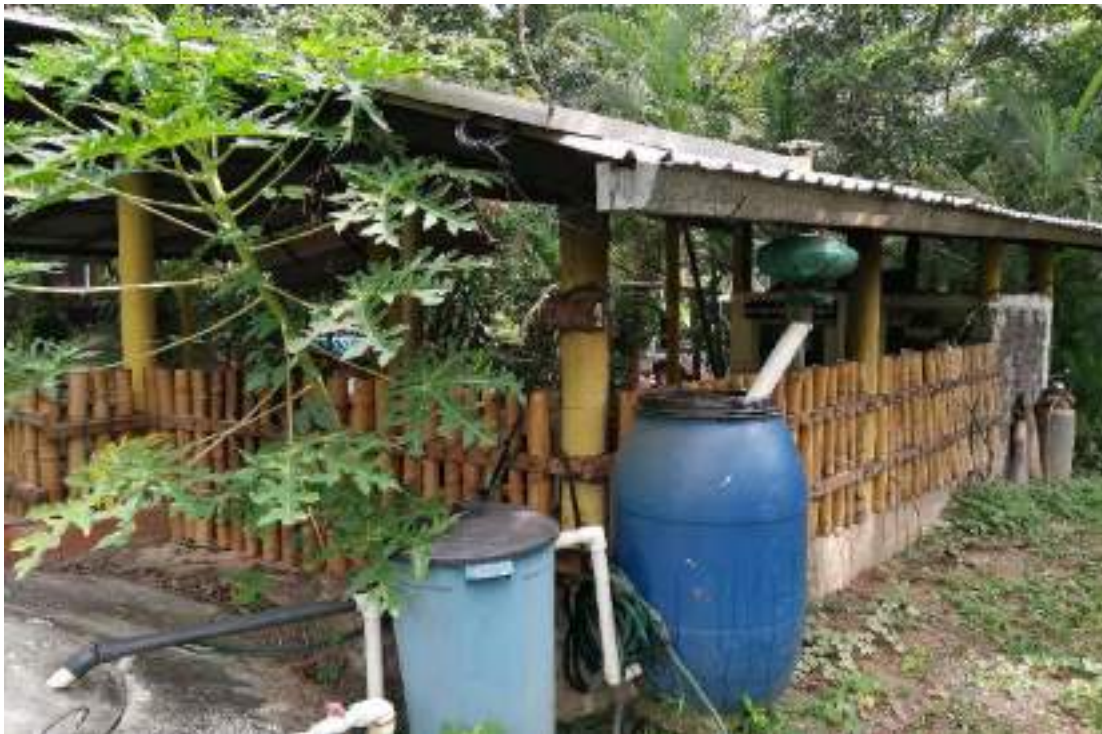
Ilustración 22 Sistema de Captación de Agua de Lluvia de CEPRODITES
