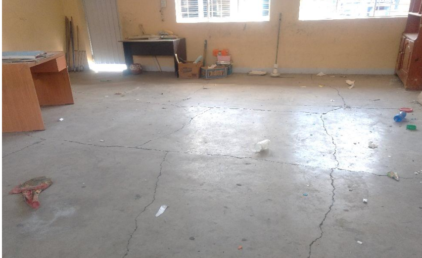
Imagen 63: Daños en edificios por sismos, escuela de la Costa chica.
