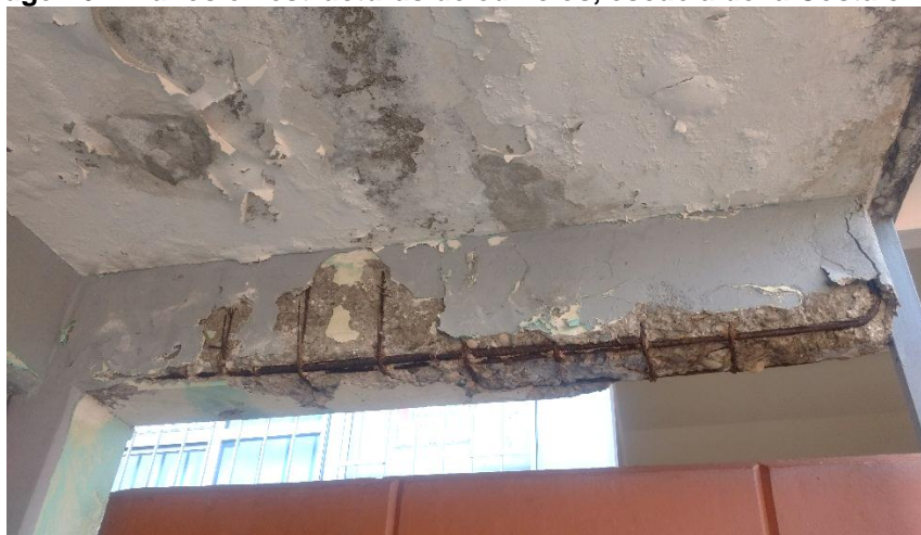
Imagen 62: Daños en estructuras de edificios, escuela de la Costa chica.
