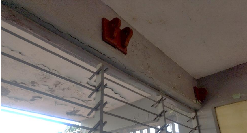
Imagen 64: Daños en edificios por sismos, escuela de la Costa chica.
