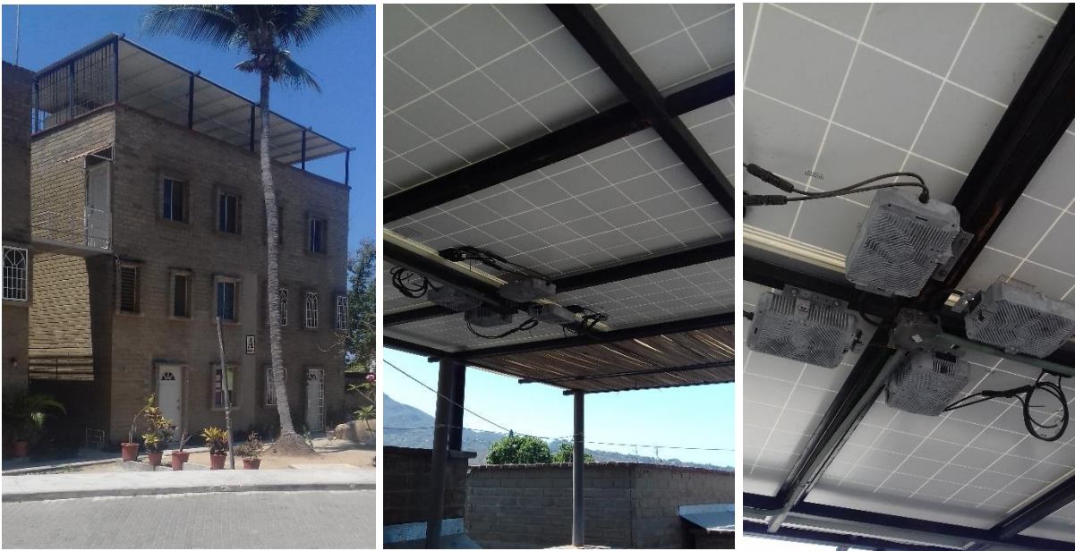
Foto 22: Uso de paneles solares fotovoltaicos para la generación de energía eléctrica
