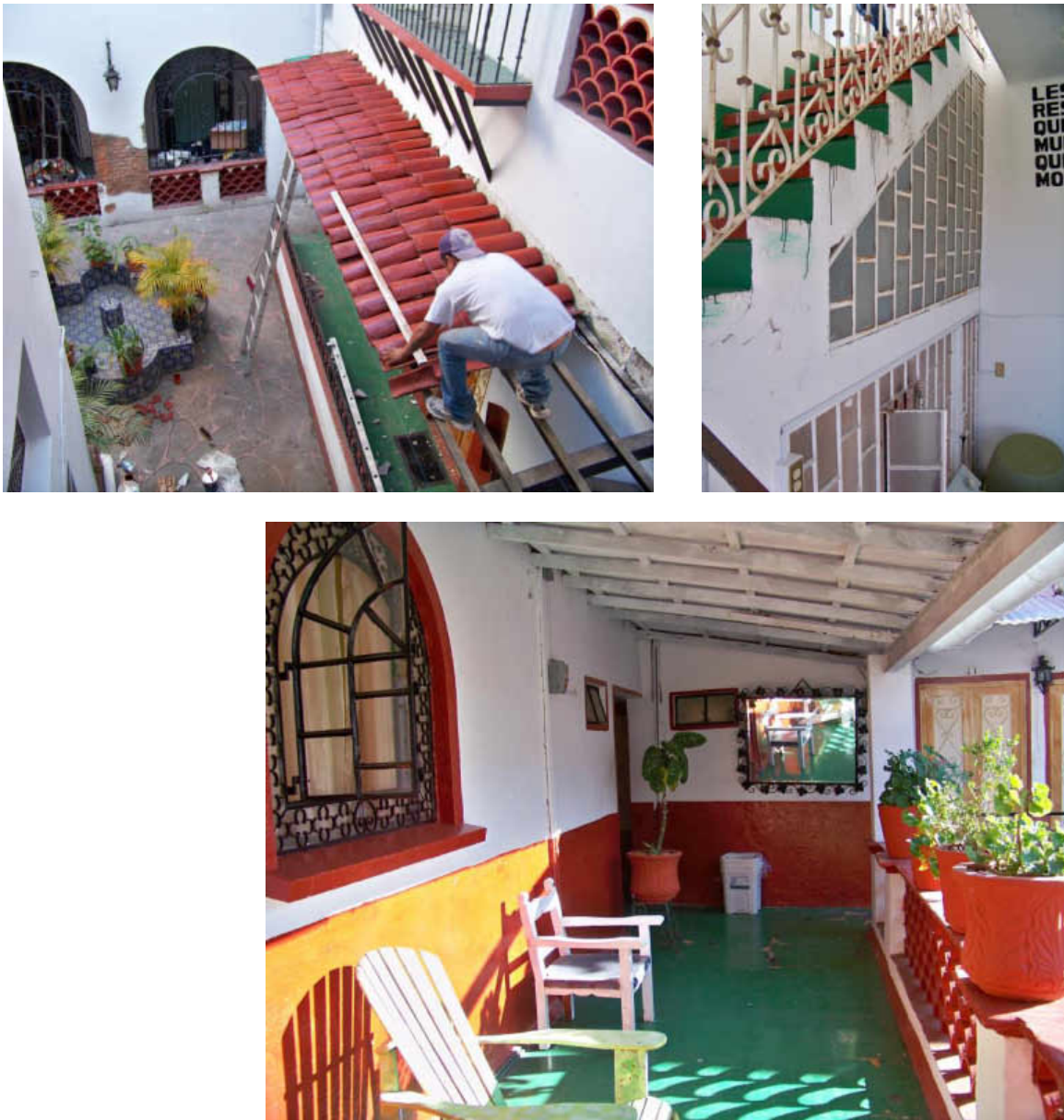
Figura 6.10, 6.11 y 6.12. Tejado, muros y pisos retocados con pintura de aceite, afectan la arquitectura original, en el hotel Meléndez. Fuente: Elaboración propia.
