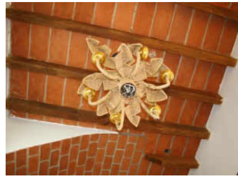
Figura 5.189. Losa plana con petatillo en Hotel El Arca de Noé. Fuente: Elaboración propia.
