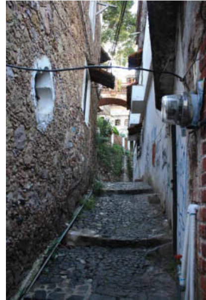
Figura 6.24. Tubería hidráulica y sanitaria visible en callejón de Taxco. Fuente: Elaboración propia.
