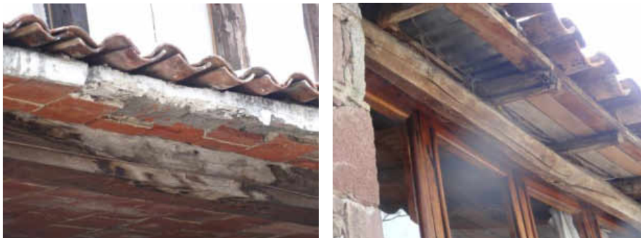
Figura 5.184 y 5.185. Deterioro en cubiertas de habitaciones de Posada de la Misión. Fuente: Elaboración propia.
