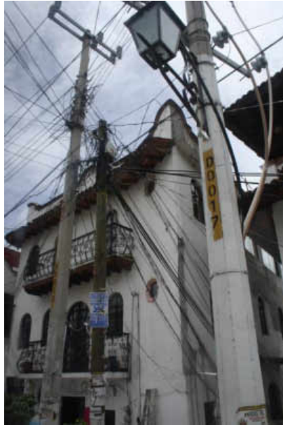
Figura 6.23. Cableado aéreo en el centro histórico de Taxco. Fuente: Elaboración propia.
