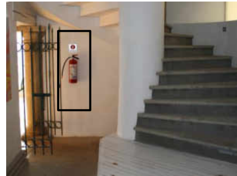
Figura 5.209. Extintor situado en pasillo del Hotel De Canteras y Plata. Fuente: Elaboración propia.
