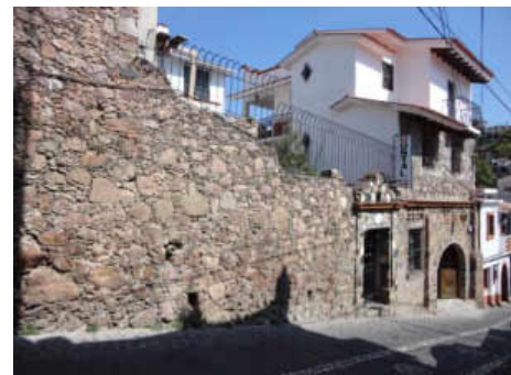
Figura 5.192. Muros de piedra en Fachada del Hotel Villa San Francisco Fuente: Jaimes, Y. y Pastrana, E.
