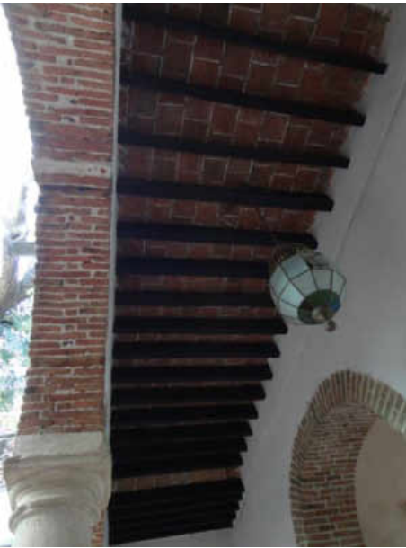
Figura 5.187. Losa plana con petatillo y vigas de madera en Hotel Los Arcos. Fuente: Jaimes, Y. y Pastrana, E.
