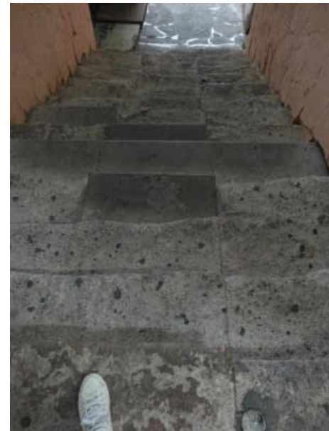
Figura 5.186. Deterioro y desgaste en escalones de Hotel Casa Grande. Fuente: Elaboración propia.
