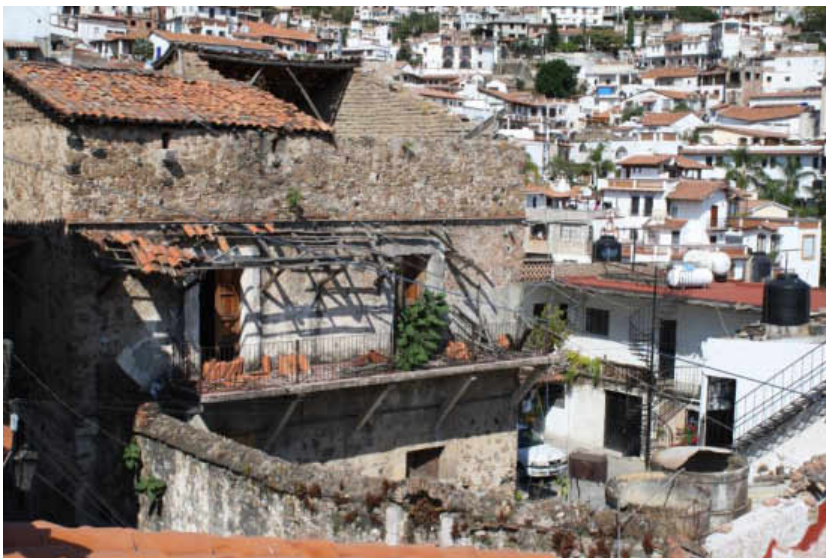
Figura 6.17. Falta de mantenimiento y conservación de la arquitectura tradicional de Taxco. Fuente: Elaboración propia .
