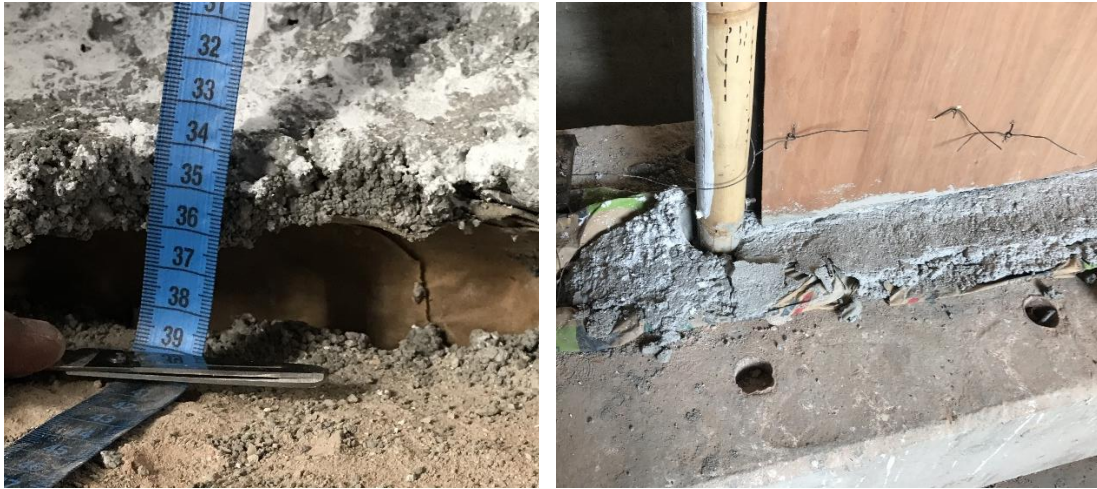
Figura 3.2.20 Cimentacion del muro con falla.
