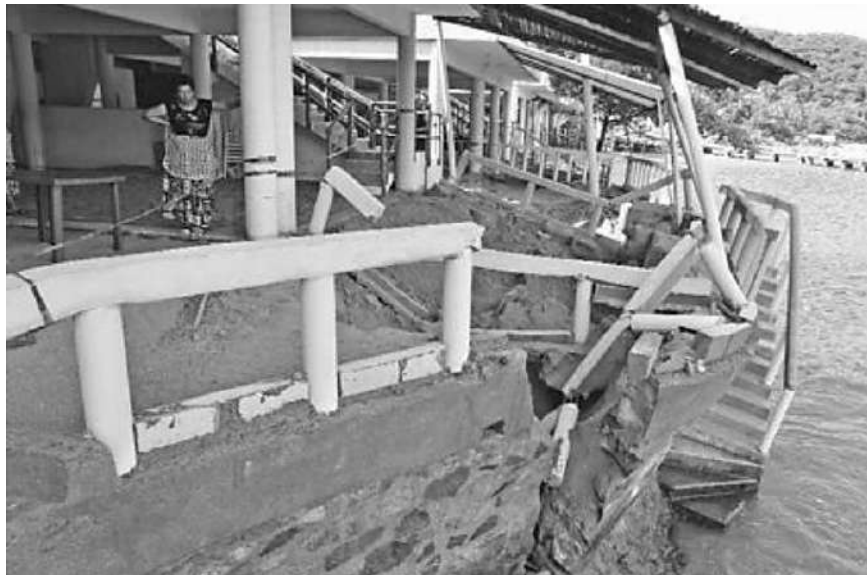
Imagen 124.- Los muros de los restaurantes La Ola y Estrellita, fueron socavados la noche del 28 de agosto de 2011, por el incremento del nivel mar que ocasionan las obras del muelle en Puerto Marqués Foto: Carlos Enrique Delgado Mora
