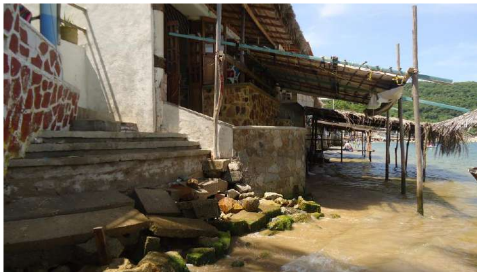
Imagen 123.- Escalera de acceso a la playa afectada por el incremento del nivel del mar, en Puerto marqués. Foto: Manuel Ruz
