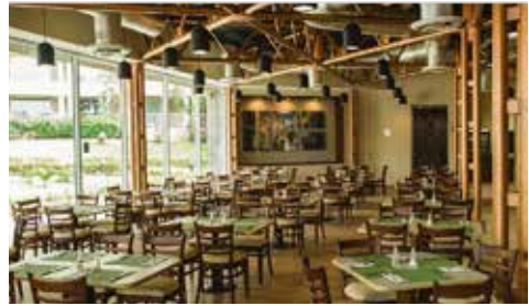
Figura 6.88. Se muestra en la parte superior los ductos de aire acondicionado en restaurante "Terraza" del hotel Azul Ixtapa . Fuente: Azul Ixtapa Beach Resorts. (2021). Recuperado de https://www.azulixtapa.com.mx/galeria
