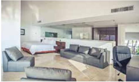
Figura 6.87. Instalación de aire acondicionado en suite presidencial del hotel Holiday Inn Ixtapa . Fuente: Holiday Inn Resort Ixtapa All-Inclusive. (2021). Recuperado de https://www.hirixtapa.com/habitaciones
