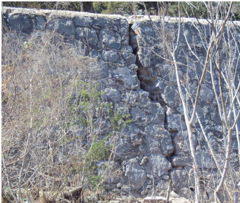
Imagen 29. Se muestra fractura en la presa del “Cerrito Rico”, fotografía tomada durante el primer mes, después del desastre de septiembre de 2013
