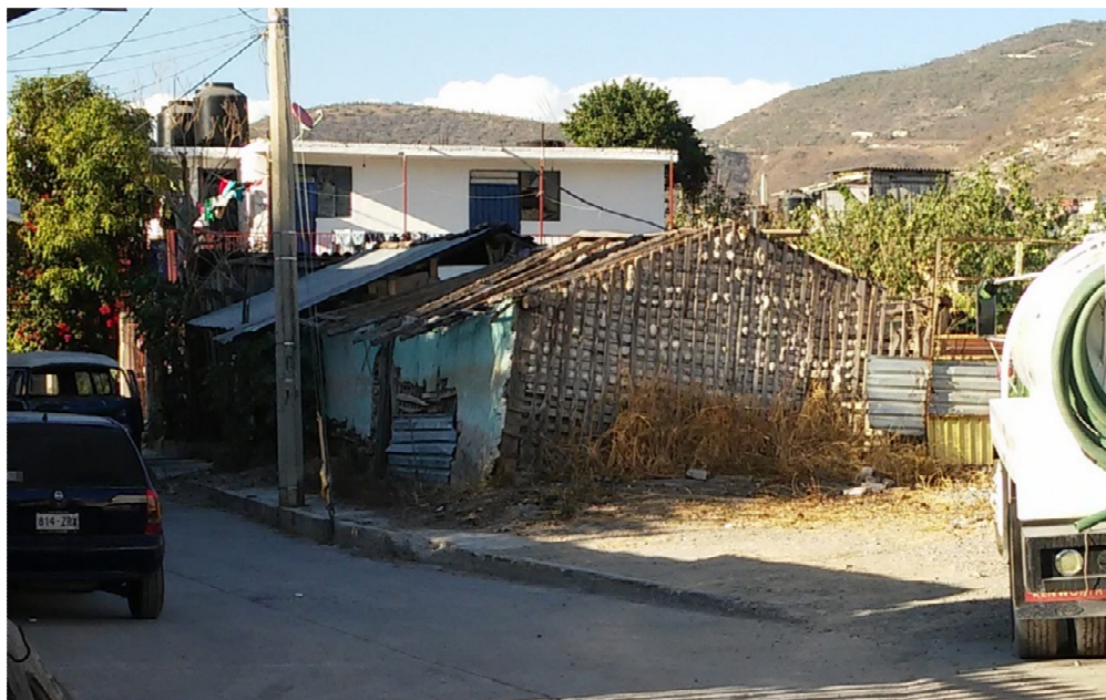
Imagen 36. Vivienda afectada en condición precaria con muros de bahareque y techo de lámina, quedó inhabitable por los daños
